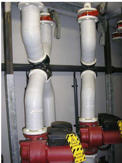
Départ d'un réseau de chaleur – SCEA du Bois Brillant (49) - © AILE
