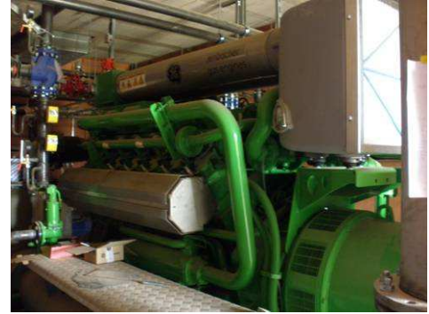
Moteur de cogénération – © AILE
