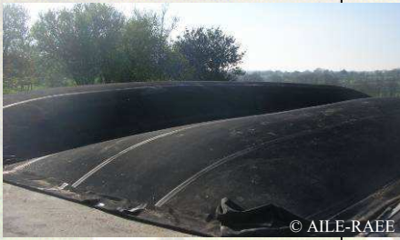
Vue sur deux des quatre fermenteurs
