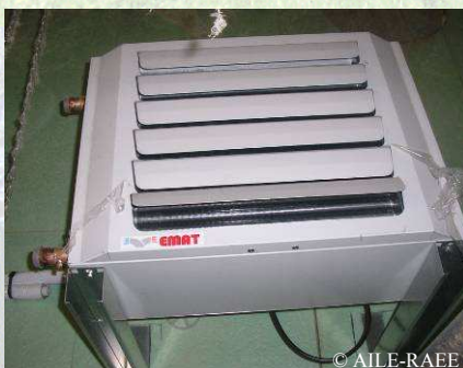
Aérotherme, système de chauffage installé dans un des bâtiment à lapins
