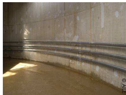
Le réseau de chauffage du digesteur
