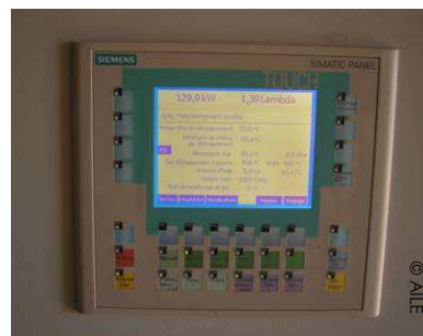
L'armoire de commandes du moteur gaz
