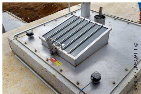
L'un des regards vitrés du digesteur
