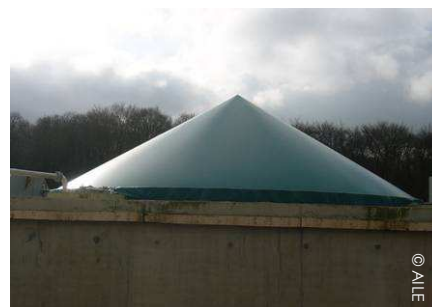
Le stockage double-membrane au-dessus du post-digester
