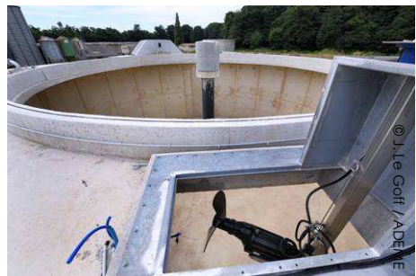
L'agitateur du post-digesteur (en arrière plan)
