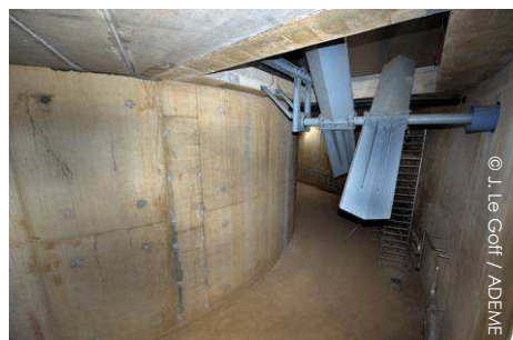
L'agitateur « Mississippi » du digesteur
