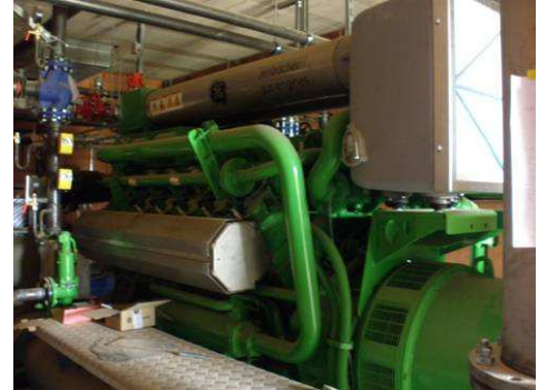
Moteur de cogénération – © AILE
