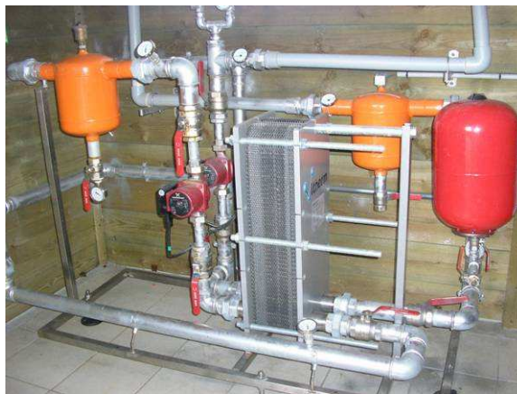
Echangeur de chaleur au niveau d'un bâtiment à canards – SCEA Bois Brillant (49) - © AILE
